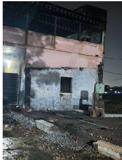
Unser Boarding in Sindhwa muss dringend renoviert werden.
